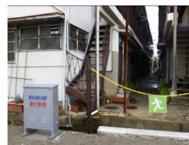
<簡易水道消火装置>
